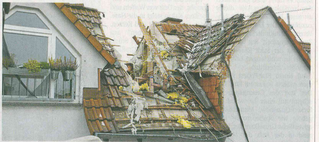
Der Kran ist im Bereich des Schlafzimmers ins Dachgeschoss gestürzt.
