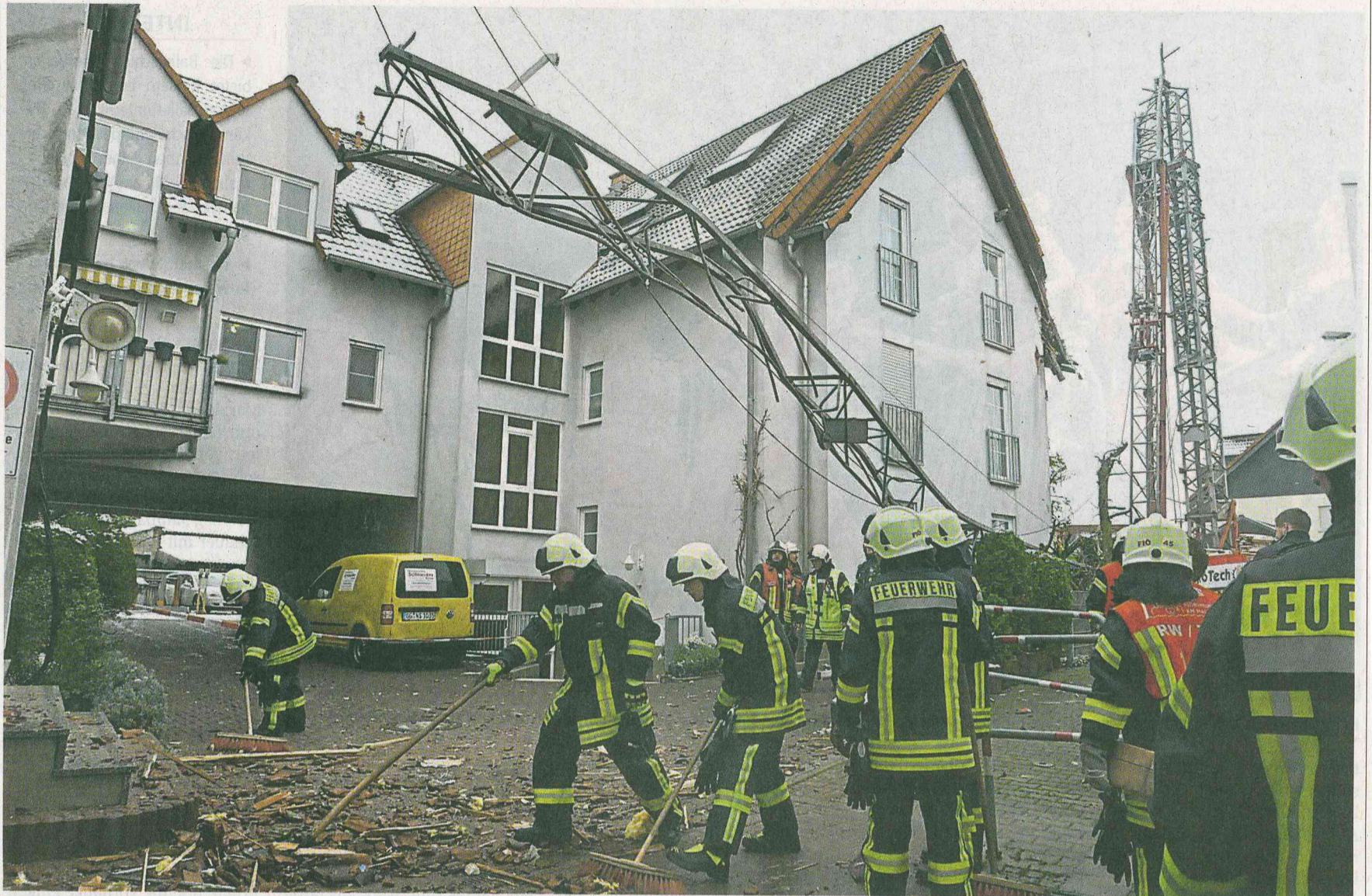
Aufräumarbeiten: Der abgebrochene Teil des Krans (rechts) hat in der Pfarrhausstraße mehrere Gebäude beschädigt.
